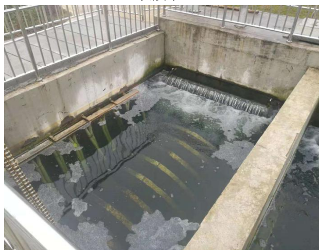
纤维转盘滤池内部
