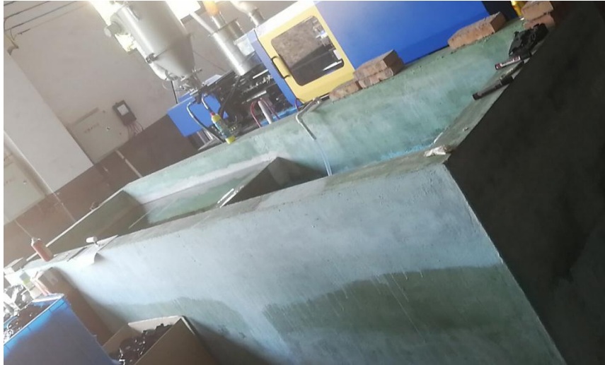
图 4-1 循环水池现场图
