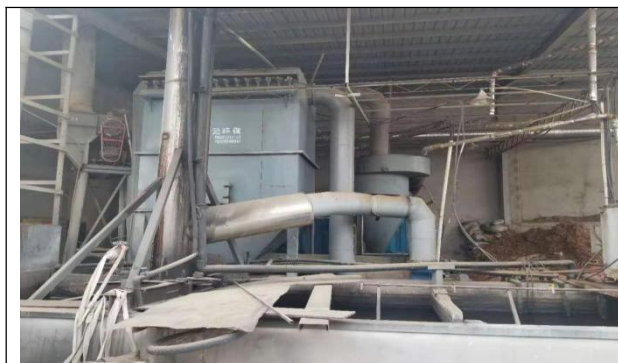
锅炉废气处理设施
