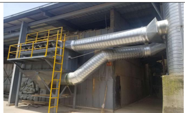
木工粉尘处理设施
