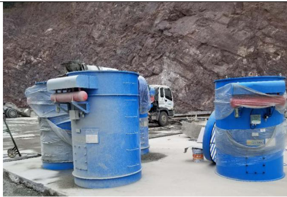
除尘器实体图
