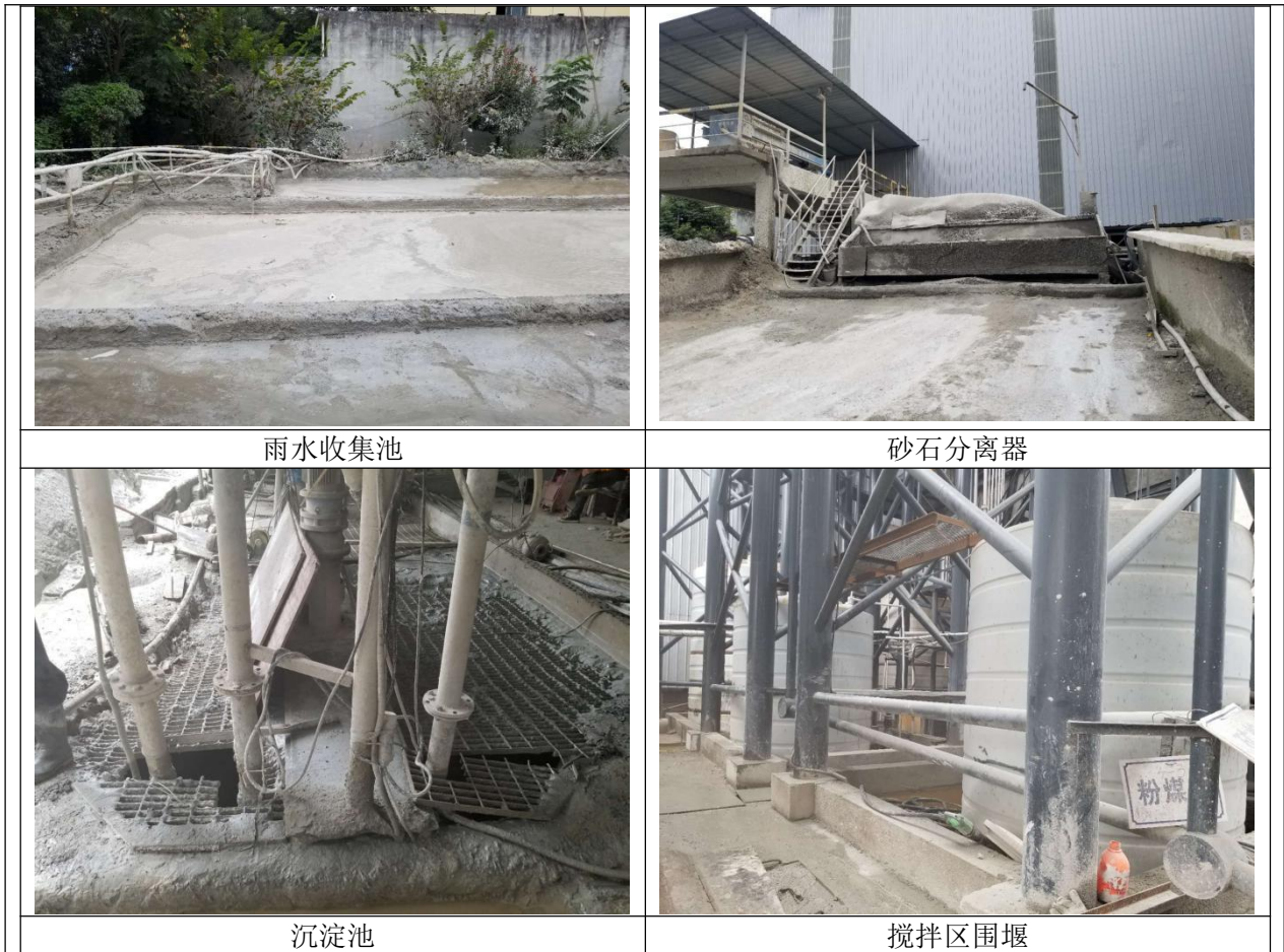
图 3-1 污水处理和收集设施现场图
