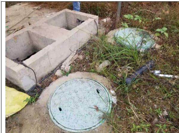
污水集中收集池
