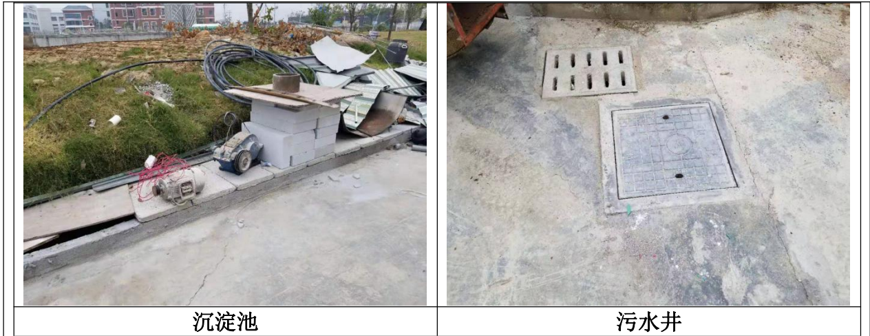
图 3-1 废水产污结点和处理设施现场图
