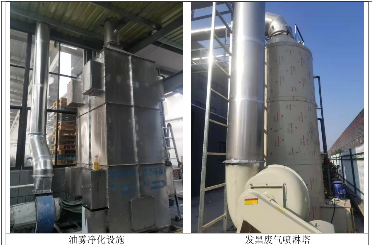
图 3-4 废气产污结点和处理设施现场图处理设施
