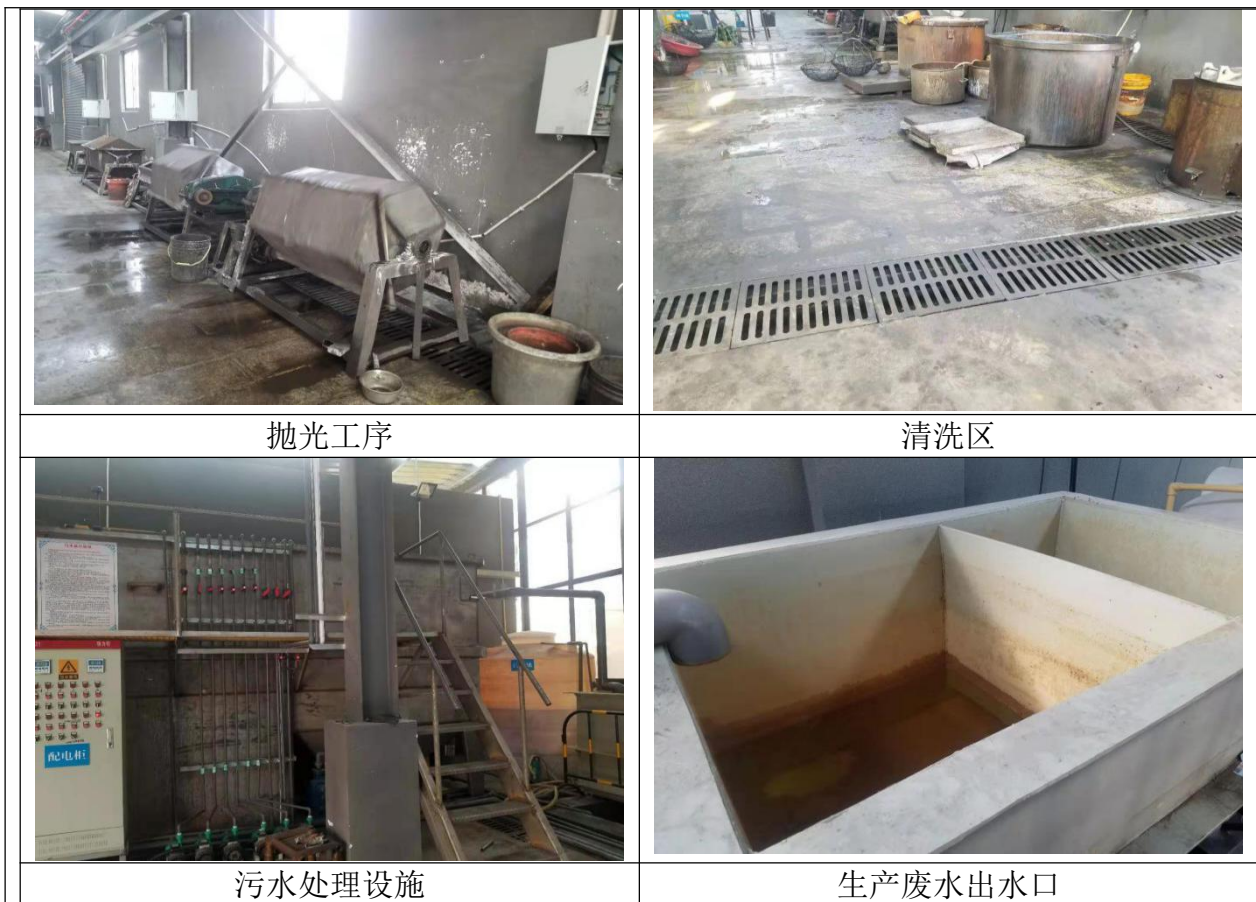
图 3-2 废水产污结点和处理设施现场图
