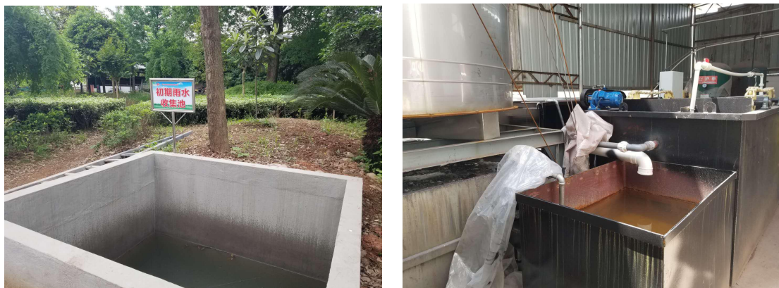
图 5-1 初期雨水收集池、絮凝沉淀池现场图
