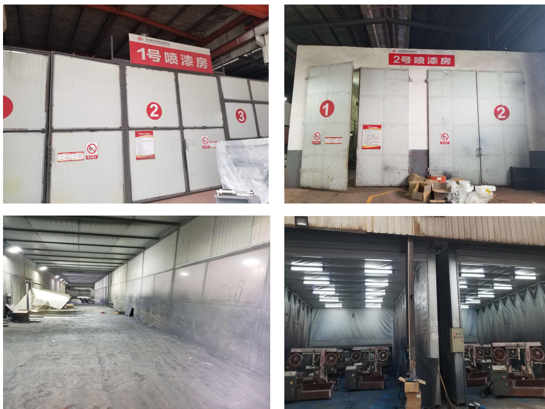
图 5-2 喷漆房现场图
