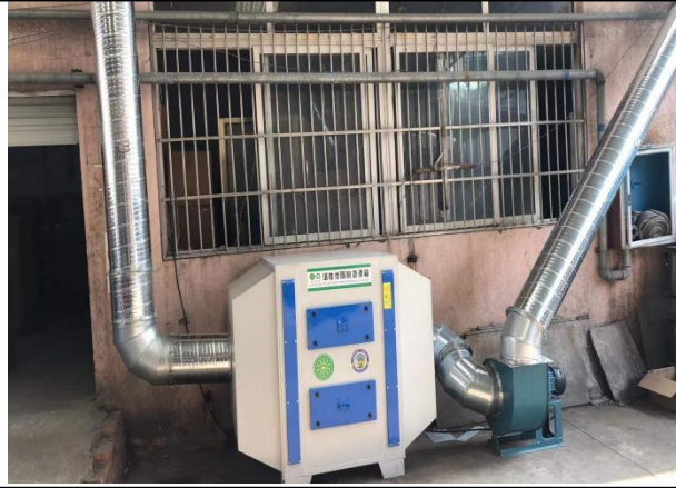
活性炭废气处理设施
