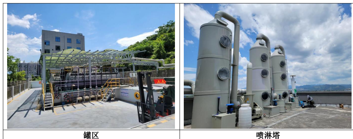
图 3-1 废气处理设施现场图
