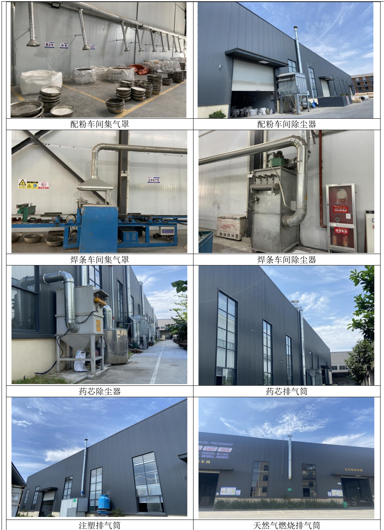
图 3-3 废气处理设施现场图
