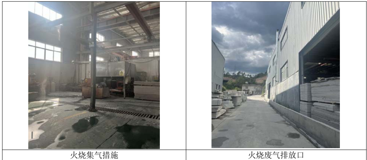
图 4-2 废气现场防治情况
