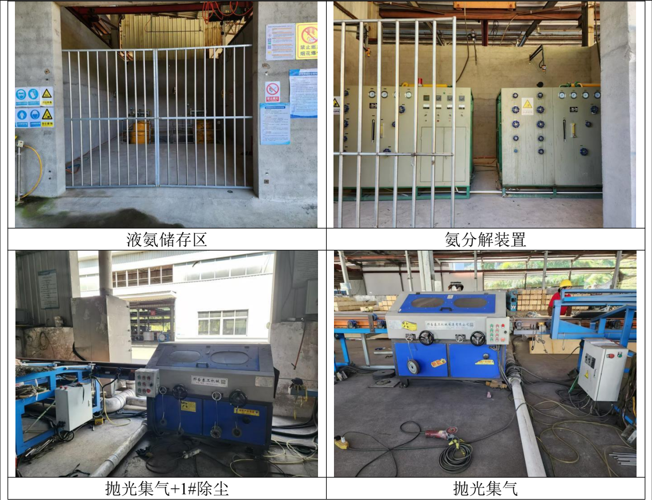
图 3-2 废气产污结点及 治理设施现场图
