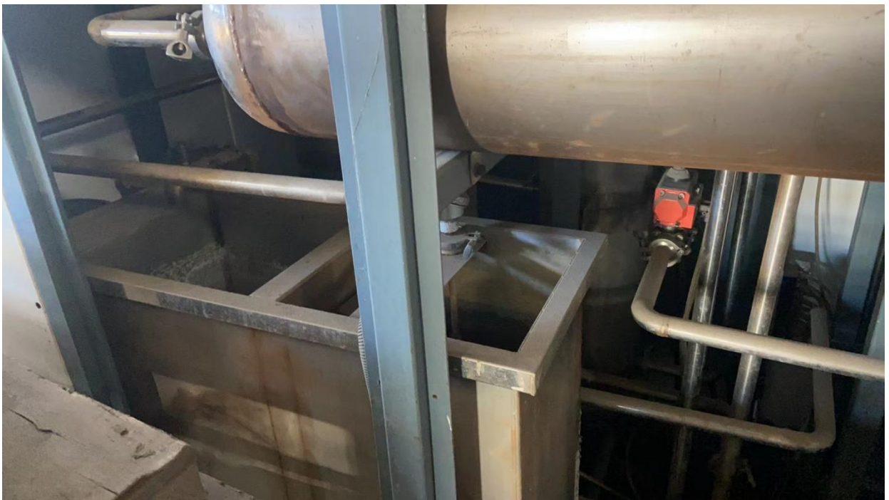
图 3-1 污水治理设施
